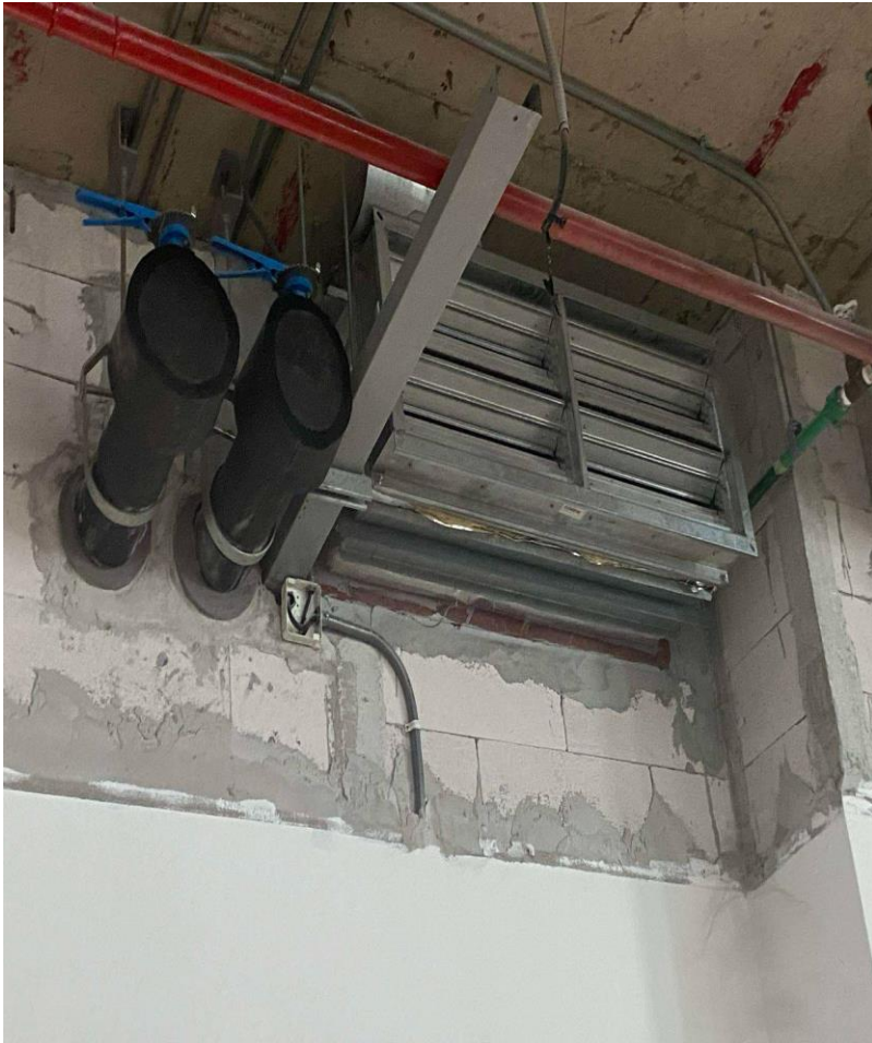
ท่อน้ำเย็น
