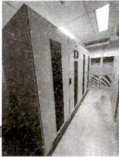
UPS อาคารโรงพยาบาล
